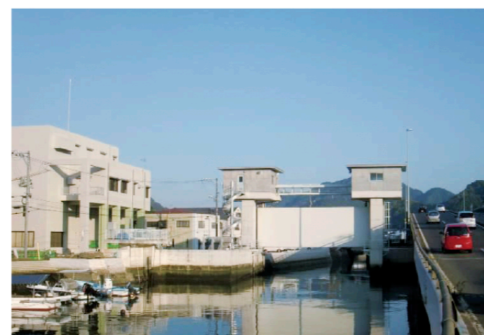
防潮水門(本川水系高潮対策)
