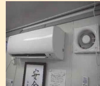
扇風機や換気扇とエアコンを併用
