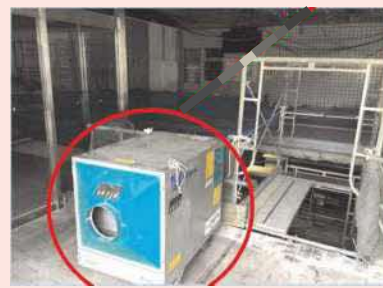
集塵機を設置し室内の換気を実施
