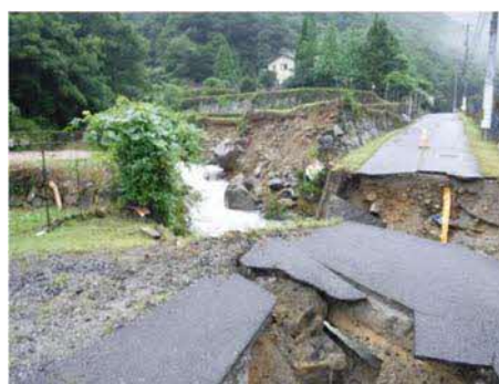
▲市道大井宿根線橋梁被災（竹原市下野町）
