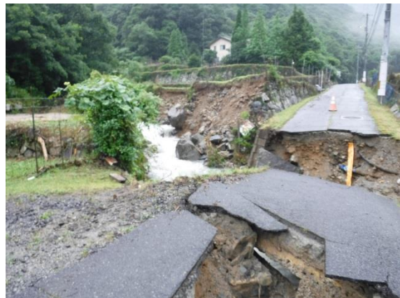
▲市道大井宿根線橋梁被災(竹原市下野町)
