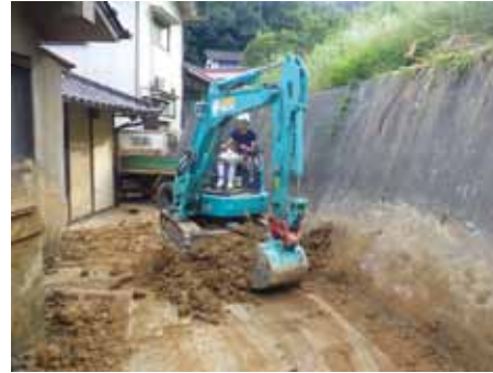
宅地等に流れ込んだがれき及び土砂等の撤去 （平成 30 年（2018）7 月 22 日撮影）
