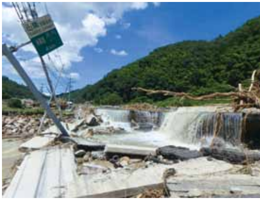
国道 432 号・葛子橋崩落（新庄町）
