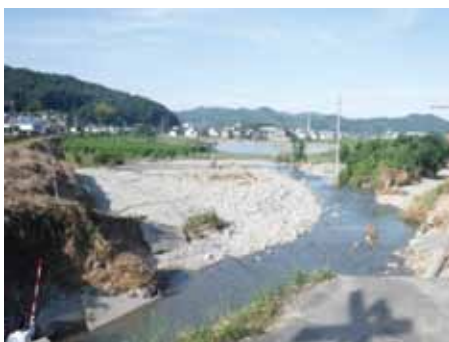
増水による堤防決壊 (平成 30 年 (2018)7 月 10 日撮影)
