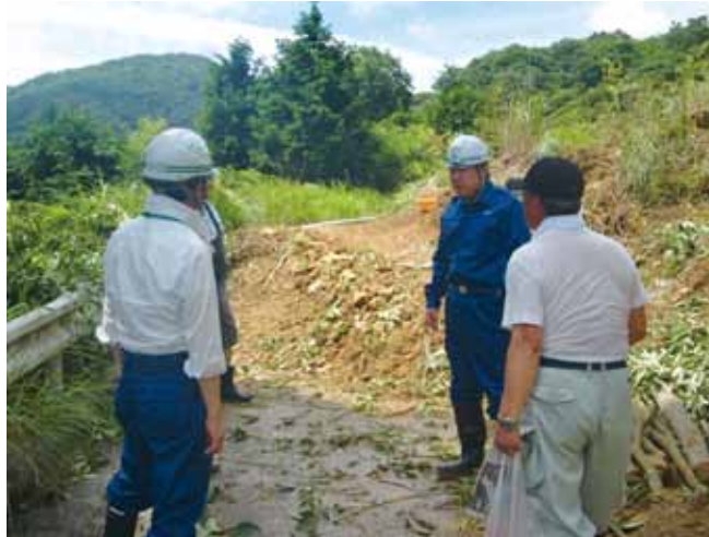
(1) 被災現場の調査（平成 30 年（2018）7 月 11 日）
