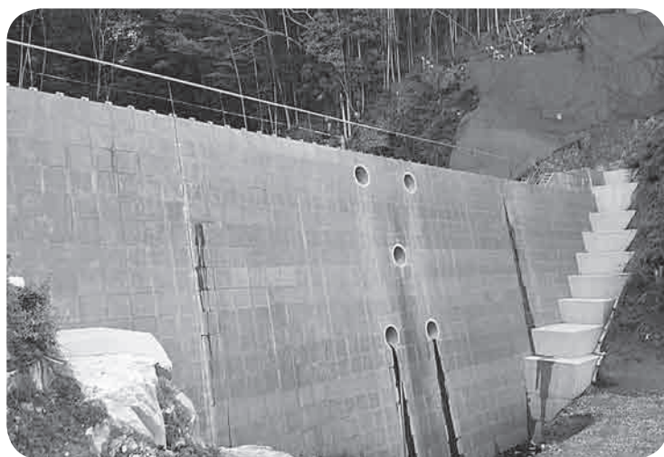
▲港町大石地区の楠谷川砂防ダム
