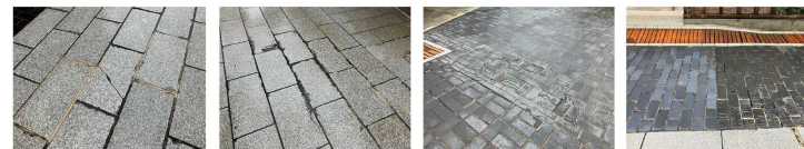
御影石のひび割れ・摩耗・剥離
