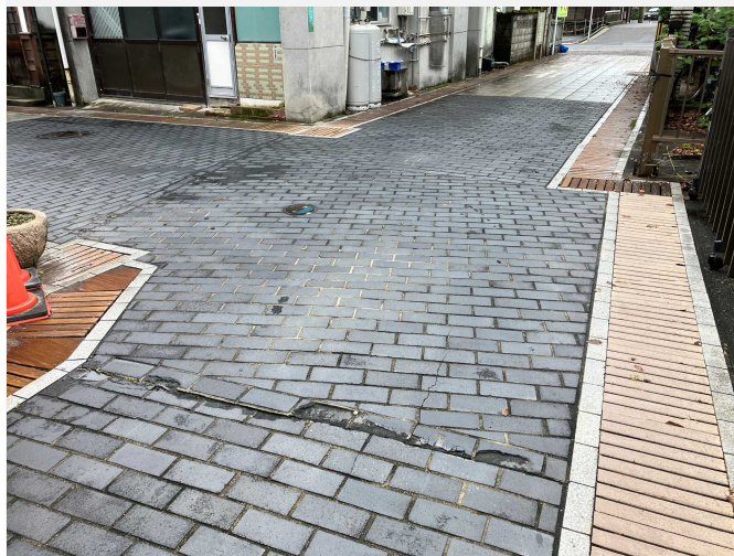
ひび割れ・摩耗
