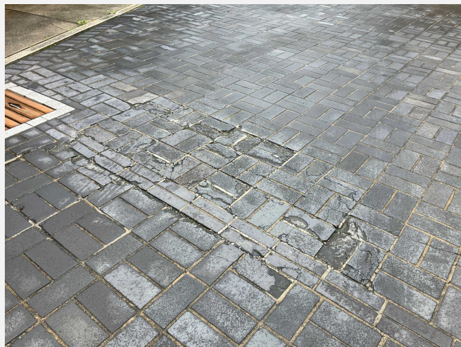
ひび割れ・摩耗
