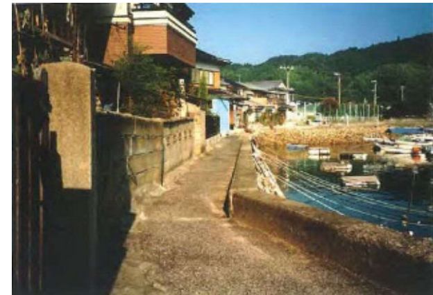
護岸背後の状況（平成15年当時）
