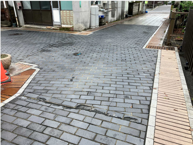
ひび割れ・摩耗
