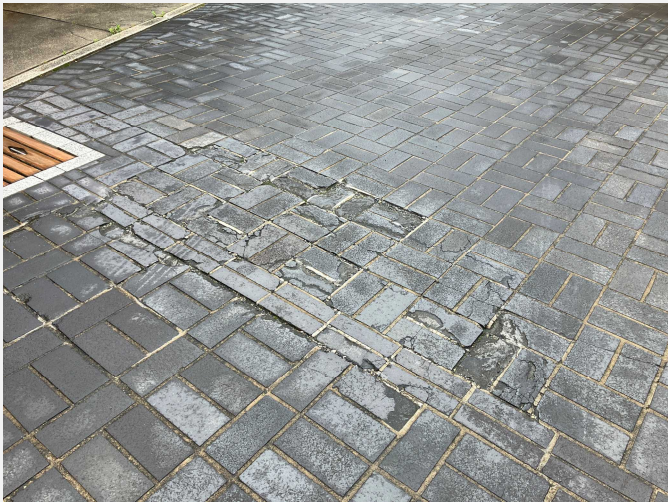
ひび割れ・摩耗
