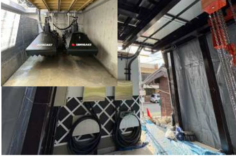
▲楠通ポンプ場及び新ポンプ
