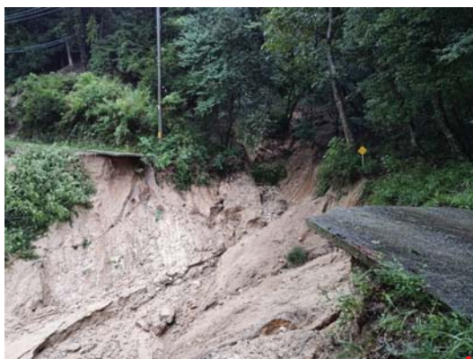
▲東野町 市道大福地西谷線道路崩壊
