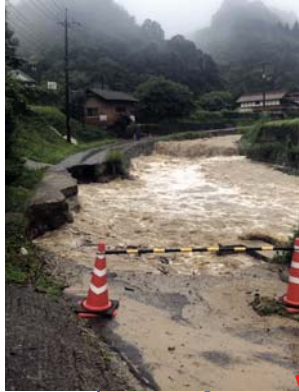
◀田万里町 田万里川 応急復旧土のう流失
