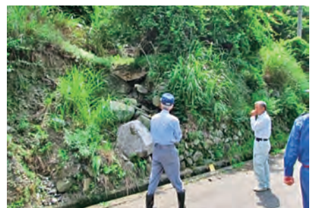
危険箇所調査
